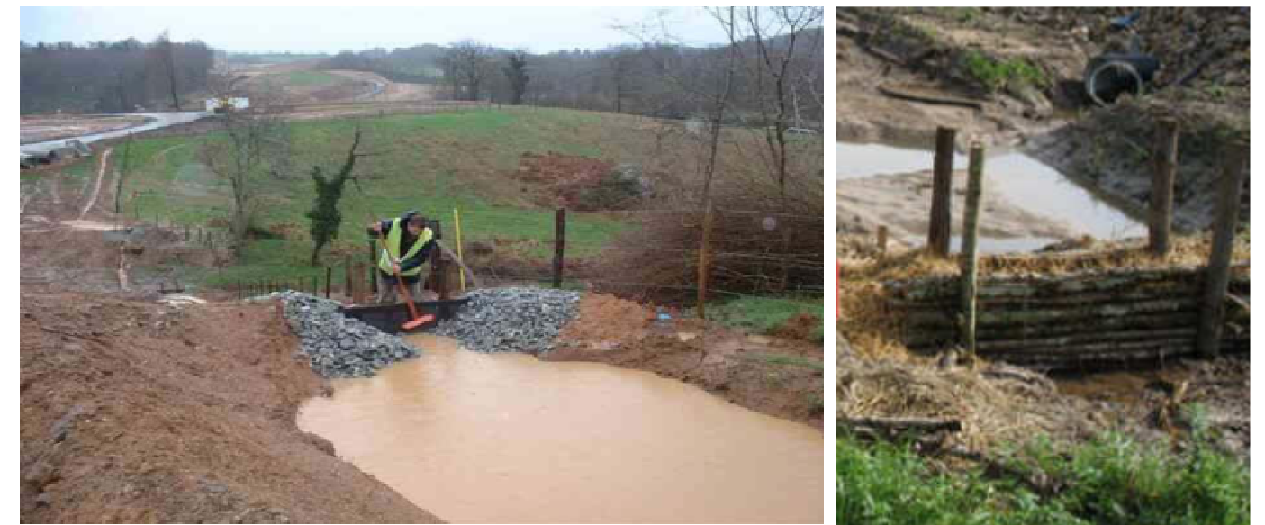
Figure 10. Exemples de système de filtration des eaux de ruissellement du chantier. Nettoyage du filtre (à gauche) - Filtre à paille (à droite) (Source : dossier de demande d'autorisation au titre de la loi sur l'eau (Source : SOGREAH - AGO, 2012)
